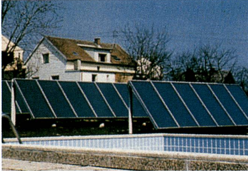
98.2 Sonnenkollektoren zur Erwärmung des Wassers in einem Schwimmbecken
